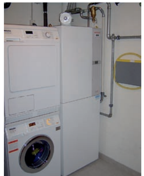
Ersatz best. Gas-Heizkessel mit Wassererwärmer Fabr. Weishaupt
